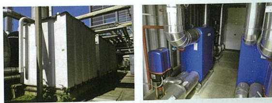
图4 换热站与热站内景
