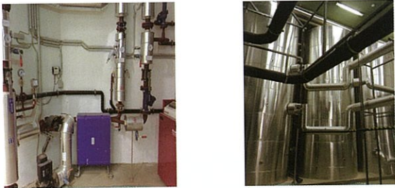
图28 Messequartier Graz太阳能区域供热设备机房
