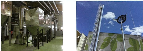
热站机房内景
